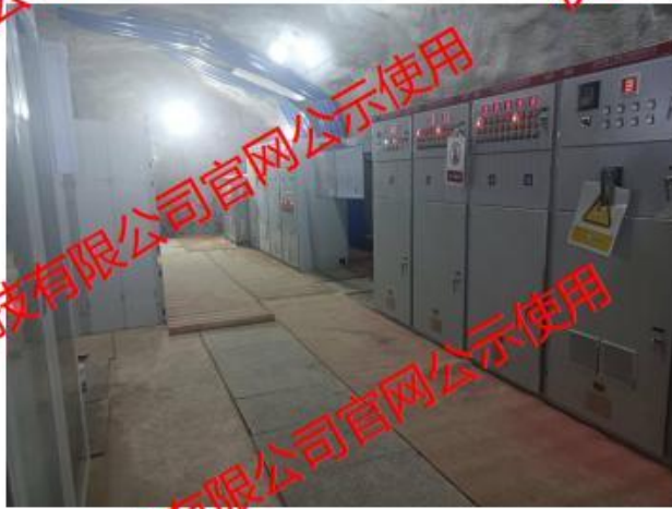
图 2-4 矿山井下低压开关柜
